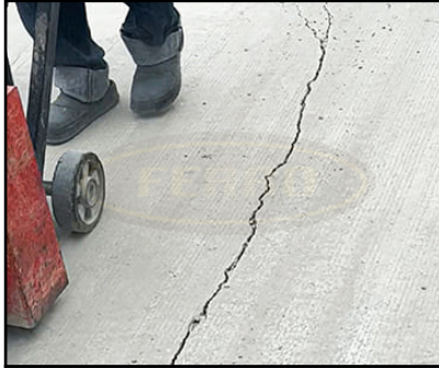
รอยร้าวคอนกรีตก่อนฉีดซ่อม
